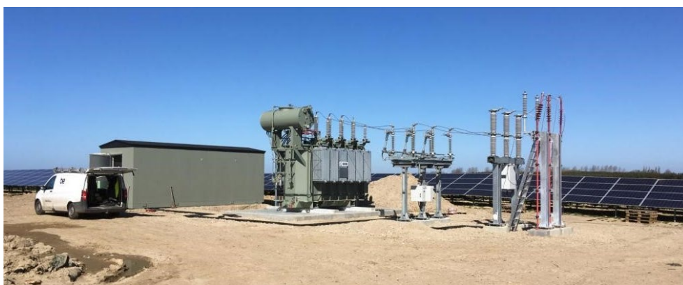
Figur 1-6 Eksempel på stepup-transformer og teknikbygning.
